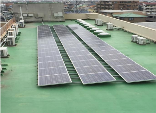
※10 平成26年度 東キャンパス 9号館屋上太陽光発電設備 設置(10kw)
