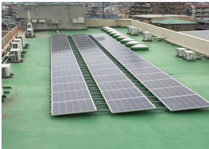
※1 平成26年度 東キャンパス 9号館屋上太陽光発電設備 設置(10kw)
